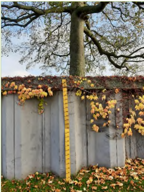
Het maaiveld aan de stadszijde is lager dan bij de boom.
