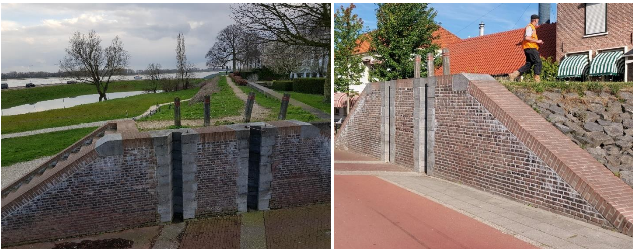
Figuur 2-6 Schotbalkspinning en -aanslag (links) en noordelijke wand (rechts)
