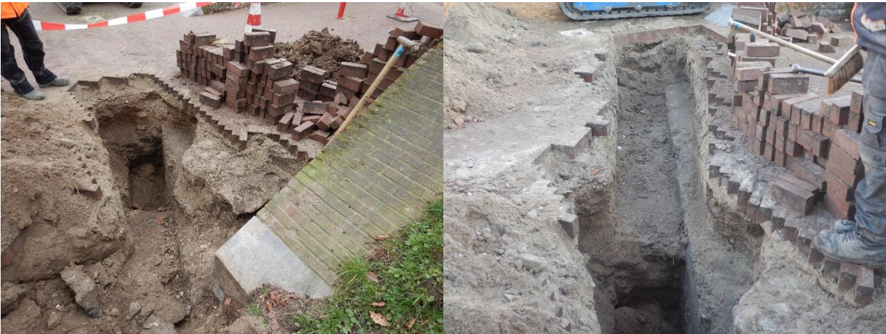
Figuur 10-15 Betonnen funderingsplaat t.p.v. zuidelijke wand binnendijkse zijde (links; zie [11]) en tussen wanden binnendijks (rechts; zie [11])
