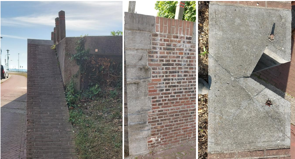
Figuur 2-7 Betonwand binnendijks zuidzijde (links), scheuren tussen natuursteen en metselwerk (aug 2020, midden) en haarscheuren bovenzijde sponningen (aug 2020, rechts)
