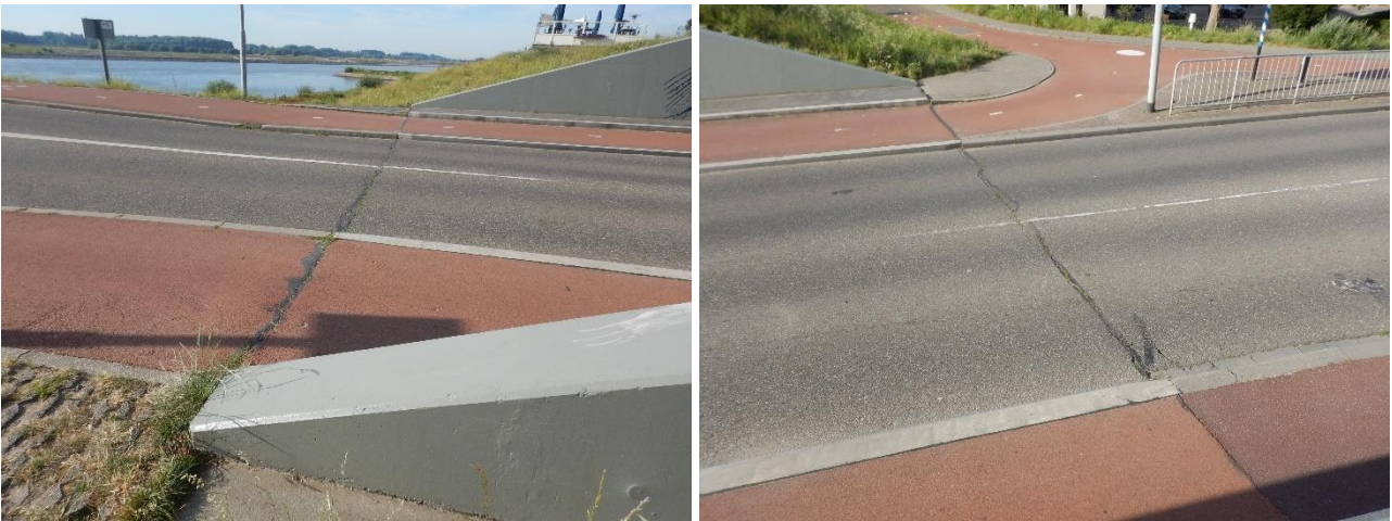
Figuur 10-6 Gerepareerde scheuren in wegdek oostelijke voegovergang (links) en westelijke voegovergang (rechts), 06-08-2020
