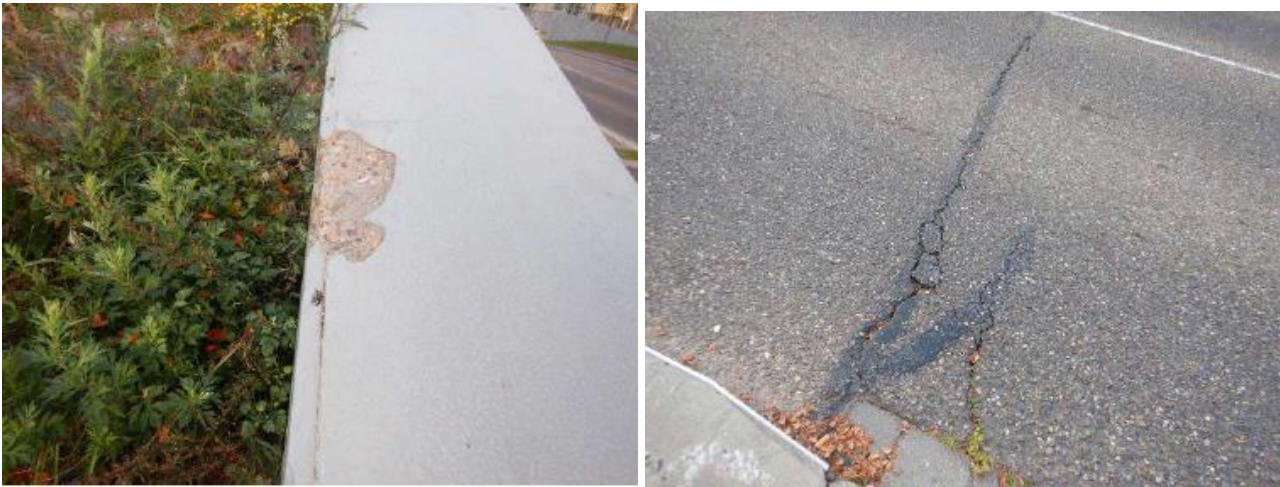
Figuur 2-10 Afgedrukte betonschol vleugelmuur (links) en scheuren bij voegovergangen (rechts; zie [6])
