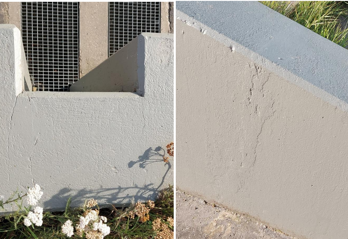
Figuur 10-8 Gerepareerde scheuren in sponning in wand (links) en vleugelmuur (rechts), 06-08-2020
