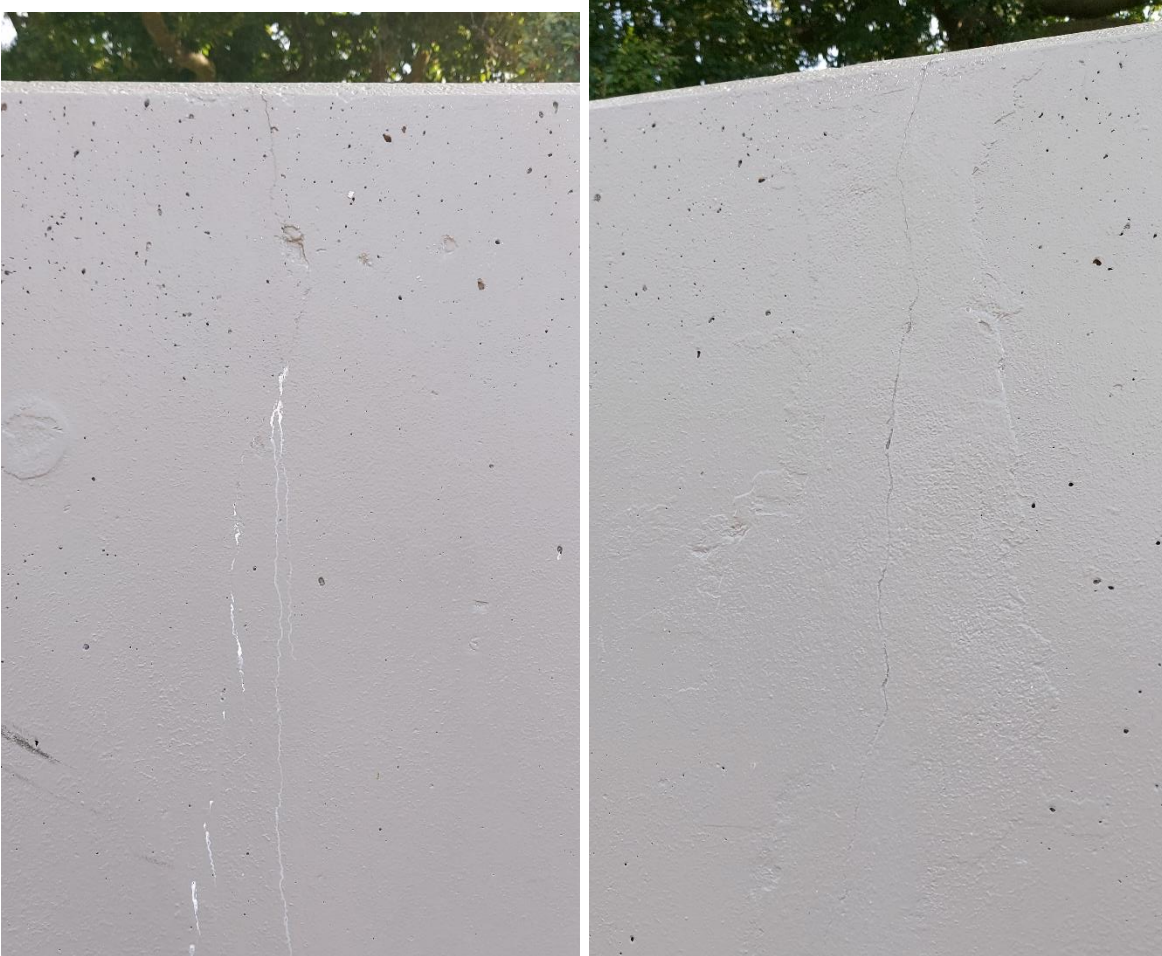
Figuur 10-9 Gerepareerde scheuren in wanden, 06-08-2020
