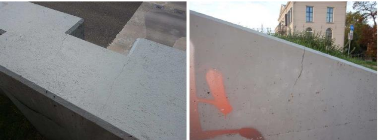
Figuur 2-9 Haarscheuren in schotbalkspinning (links) en bovenzijde wand (rechts; zie [6])
